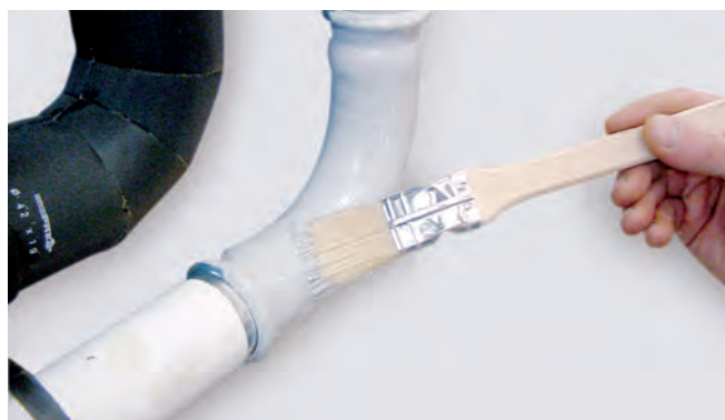
Bilde 42 – Grunn koblinger og rør.
